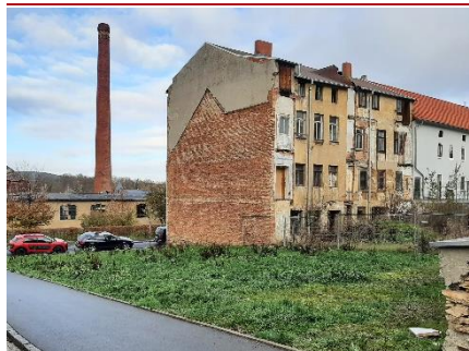
Unsanierete Leerstände in der Turmstraße Fotos: Büro für urbane Projekte / FAGUS
